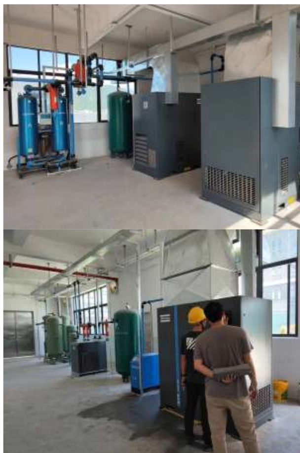
1 台 55kW 及 1 台 75kW 永磁電機及變頻功能的節能螺桿空氣壓縮機
